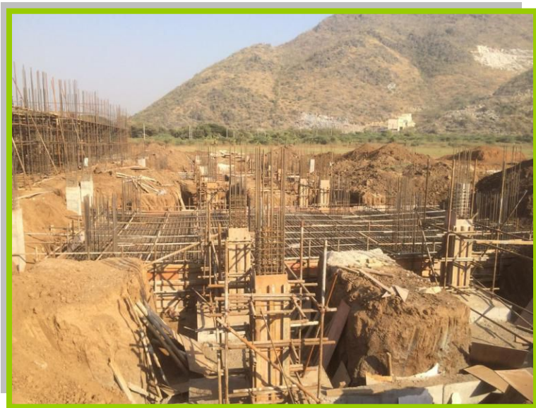
缅甸皎施余热发电项目
